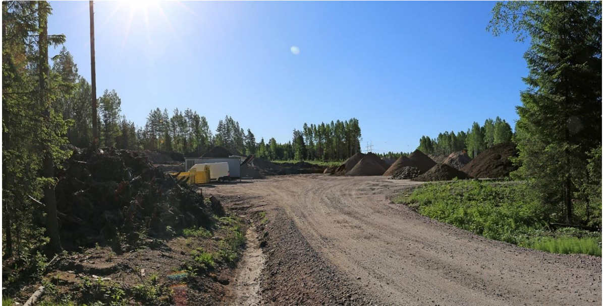
Kuva 4-3. Hankealueen puustoa on poistettu ja varastokenttää rakennettu hankealueen länsiosaan. Kallio nousee, paikoin avokalliona, kohti Tuusulan rajaa. Kuvassa taustalla näkyy Fingrid Oyj:n 400 kV voimajohto. Kuva otettu 24.5.2018.
